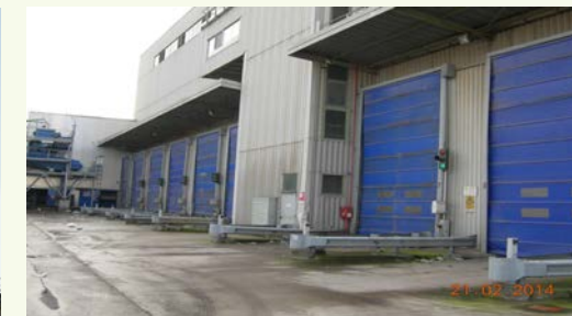
Portoni di accesso scarico in fossa
