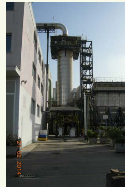
Sistema abbattimento emissioni
