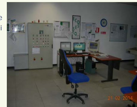
Sala di controllo del termovalorizzatore
